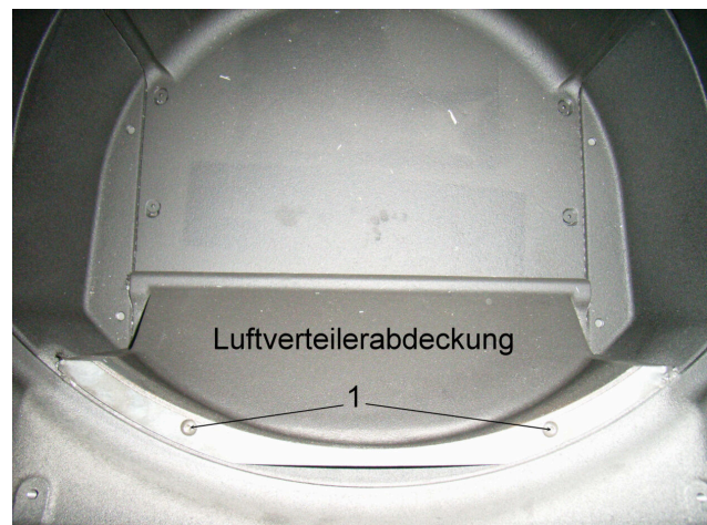
Abbildung 19: Gußboden mit Luftverteilerabdeckung
